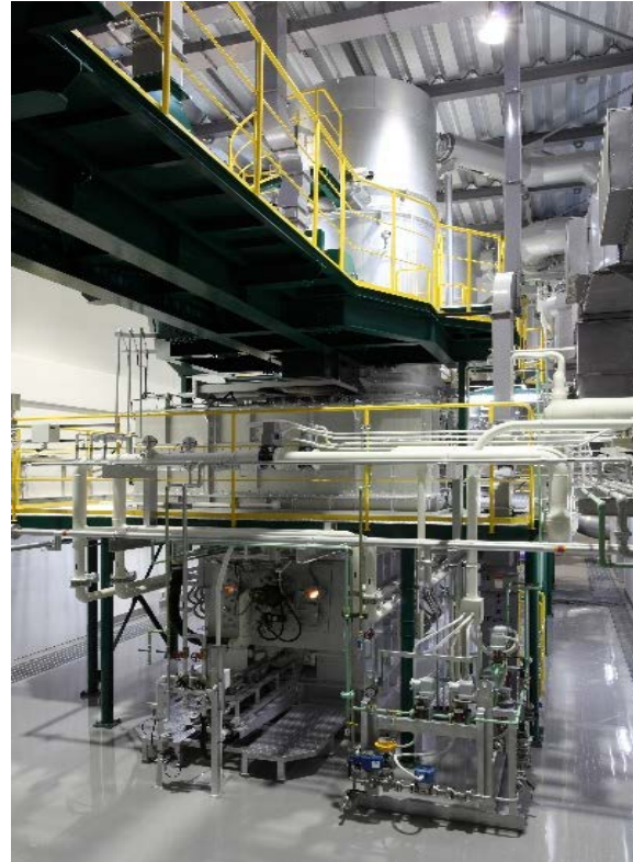
■ 有機液体・動物焼却処理設備
