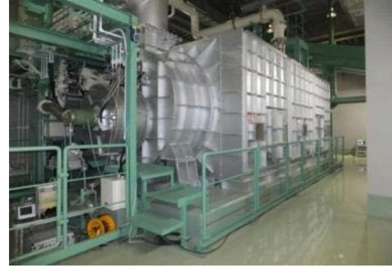
■ 仮焼処理設備
