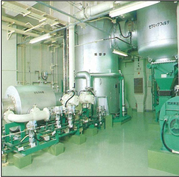
■ 焼却処理設備
